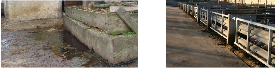
Slika 6: Neurejeno kmečko dvorišče (levo) in urejeni odtoki na koncu izpusta za lovljenje onesnaženih tekočin (desno)
