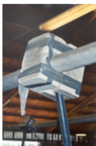
Slika 4: Zaščita vodovodne napeljave (Foto: Karmen Ložar)
